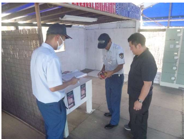
設置されている消火器の確認
