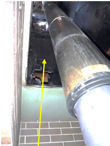
離隔距離が取られ、遮熱材も張られているが、煙突内の異常燃焼により熱伝導したものの
