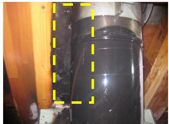
煙突と壁が接していたもの
