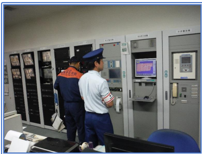
防災センターにて集中管理の状況確認を実施
